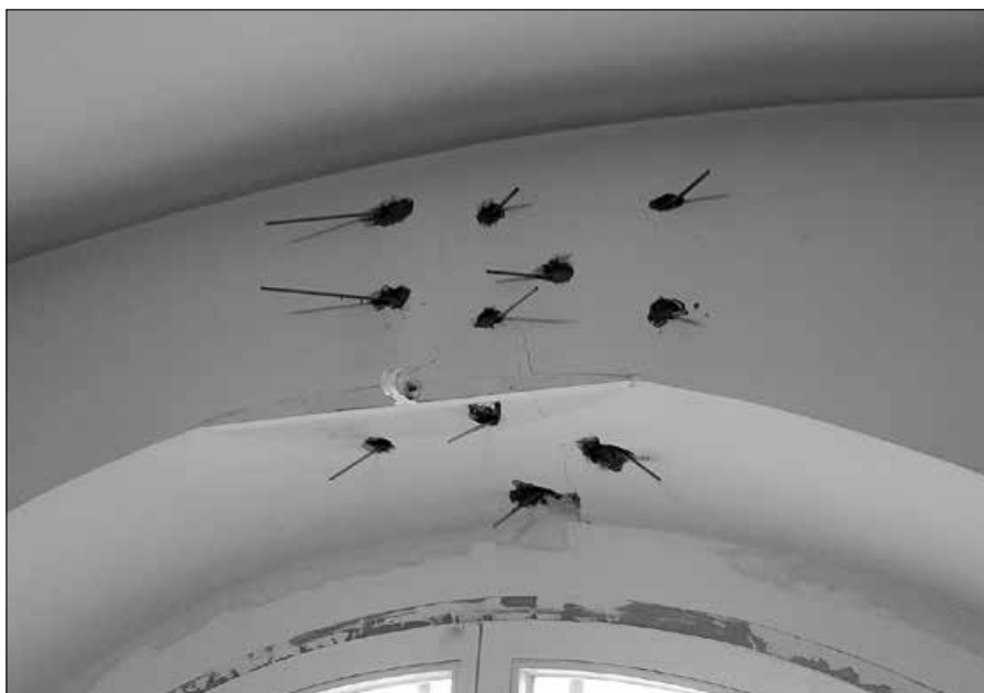
Spinanie pęknięć ścian w pomieszczeniach archiwum
