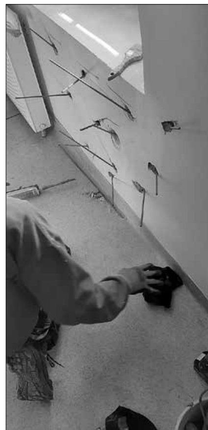
Spinanie pęknięć ścian w pomieszczeniach archiwum
