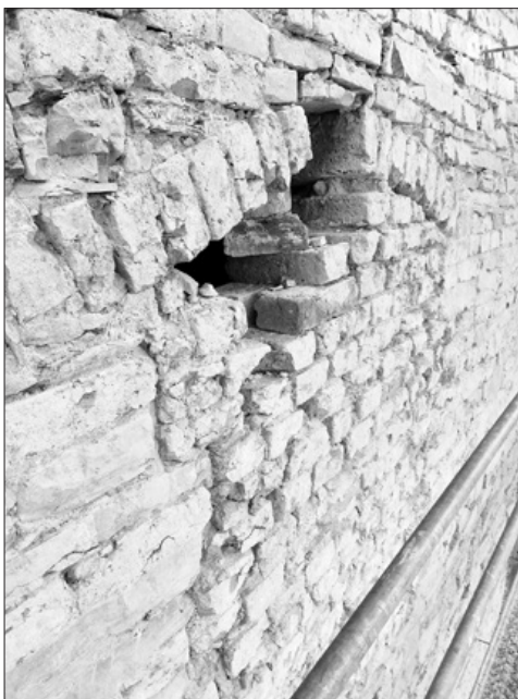
Odkryte w trakcie skuwania tynku okno techniczne
