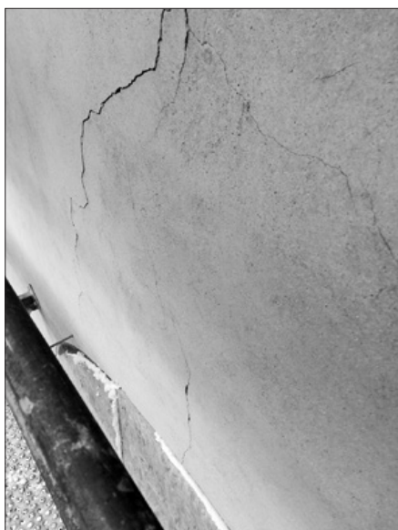
Pęknięcia elewacji w partiach górnych kościoła 2
