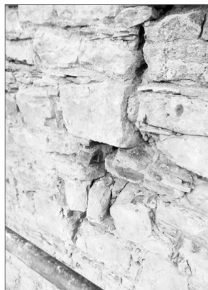
Pęknięcia w ścianach bocznych strona południowa kościoła, aysokość czwartych okien 2
