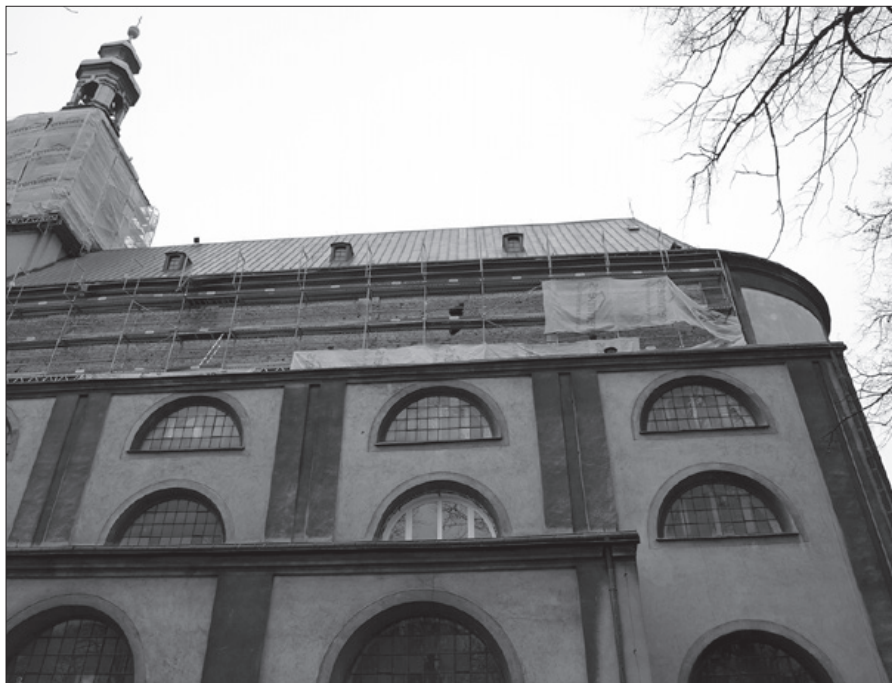
Skuty tynk w górnej części ściany południowej kościoła foto Marcin Gabryś
