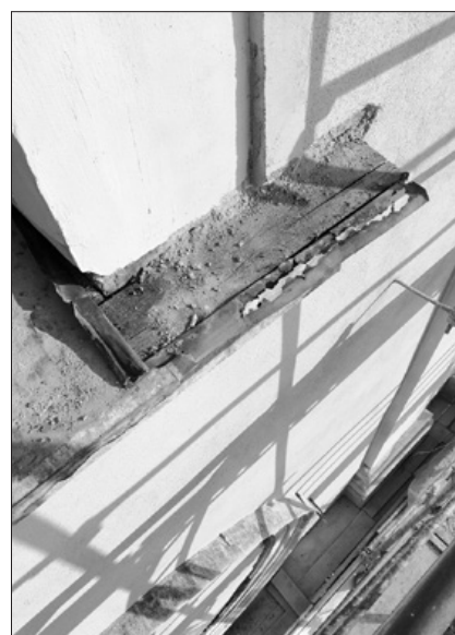
Spróchniała deska pod okuciami z blachy na wieży
