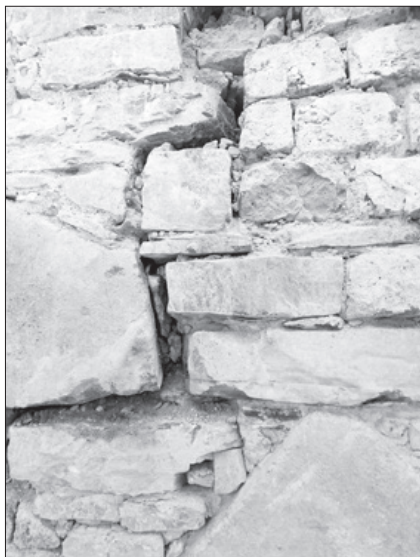
Pęknięcia w ścianach bocznych strona południowa kościoła, wysokość czwartych okien
