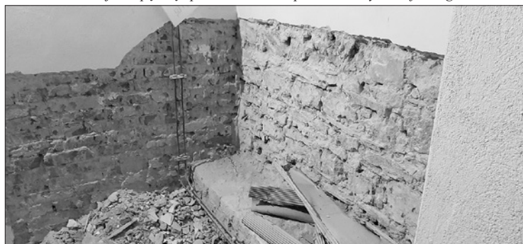
Skute tynki w kaplicy prawej w kościele fot. mg
