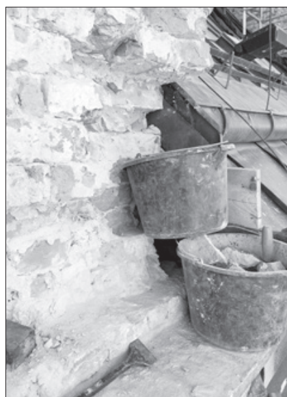
Ubytki na wieży
