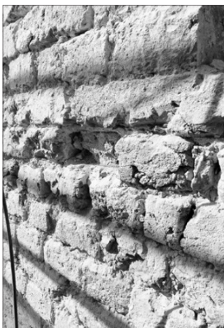
Zwietrzałe cegły i ubytki w ścianie
